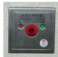
排煙口開放函
