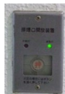
排煙口開放装置
